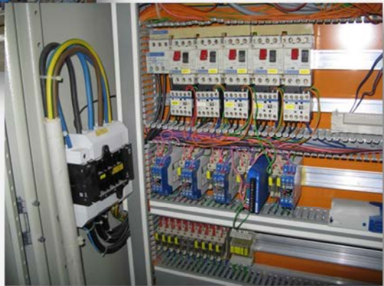
Schaltschrank einer Biogasanlage.
